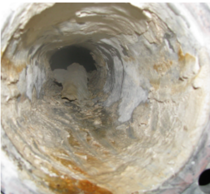
Tubería de acero inoxidable
